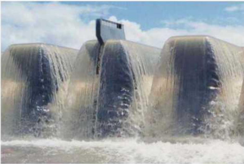
Εικόνα 2.4 Υπερχειλίση fusegates με τη στάθμη του νερού κάτω από τη στέψη του χείλους της χοάνης
